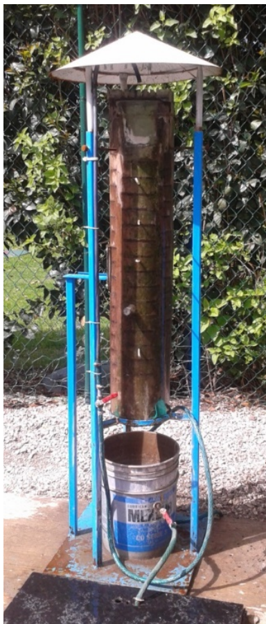
Fig. 1. Filtro percolador en las instalaciones de la PTAR-UDLAP.
